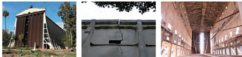
写真2 飛行船格納庫(鉄筋コンクリート造)：外観、ひび割れ状況、補強工事後の内観
