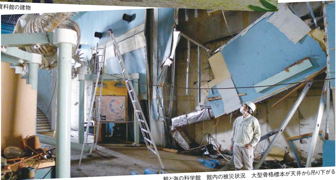
若柳郷土資料館 倒壊した資料館の建物
