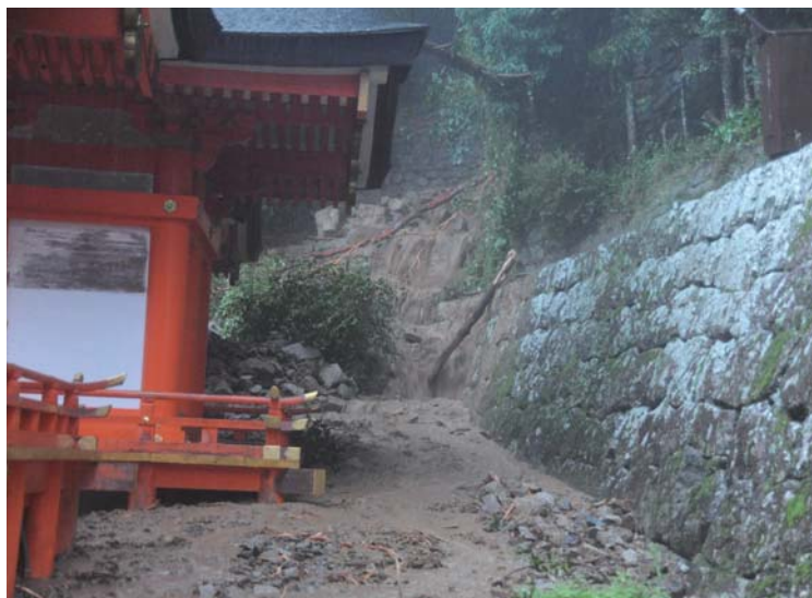
御本殿(手前より)、第四、第五殿後に土砂流出する
