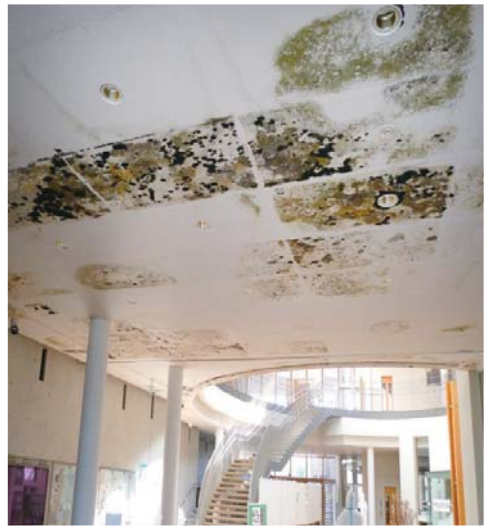
劣化著しい施設内部（富岡町）
